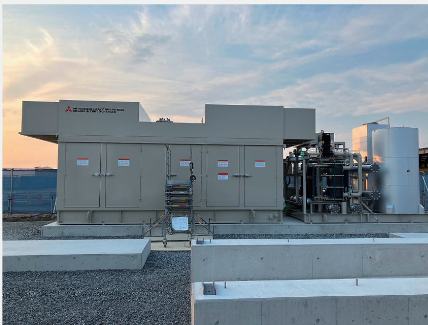
熱供給施設向けに使用されるガスコージェネレーションシステム
