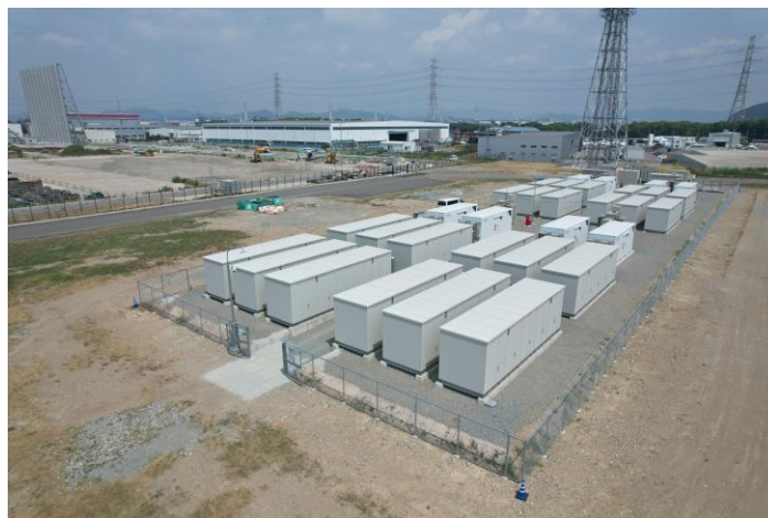
（姫路蓄電所／2025 年 8 月撮影）
