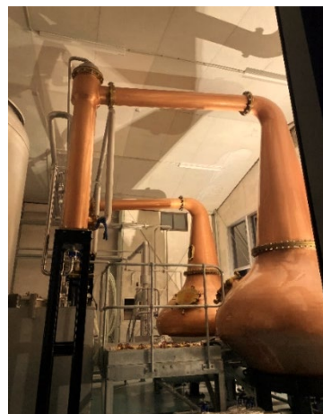
【ウイスキー蒸溜設備】
