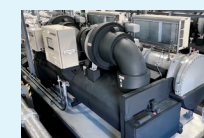
リユース活用した熱源設備
