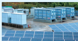
蓄電池を併設した太陽光発電所
